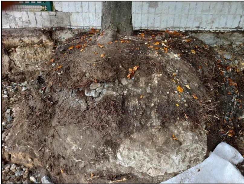
Photo 18 : Travaux de terrassement trop important ne laissant qu'une motte racinaire réduite. L'ancrage et la nutrition de l'arbre ne sont plus assurés
