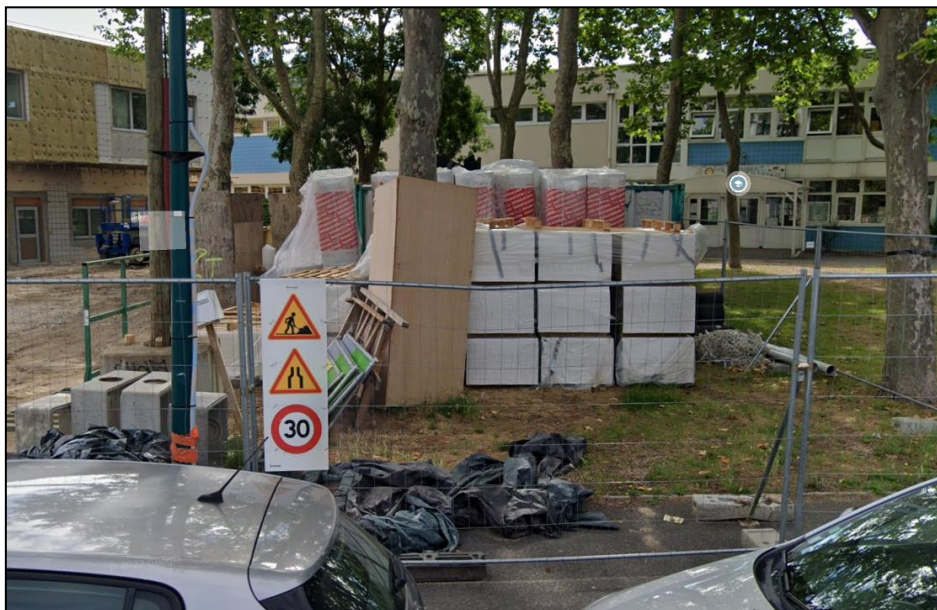
Photo 17 : Stockage de matériel au pied des arbres.
