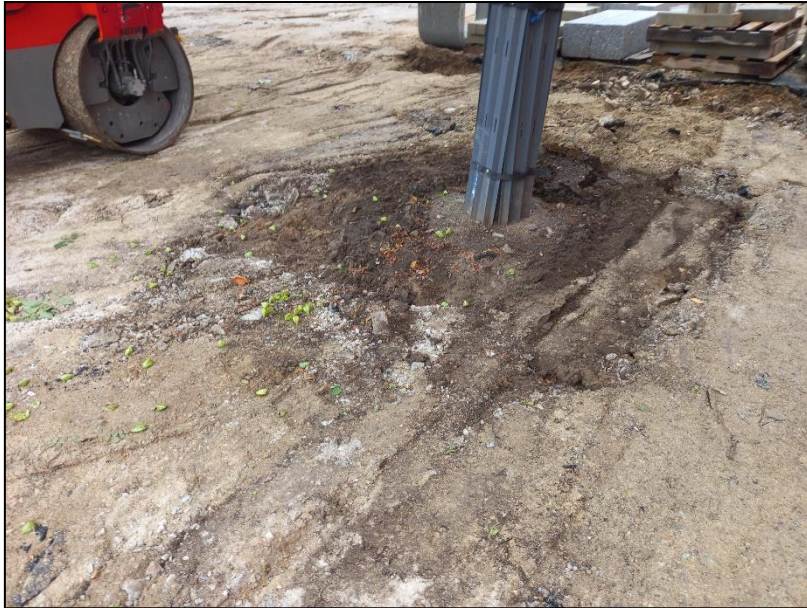
Photo 16 : Circulation des engins de chantier et entreposage du matériel à proximité d'un arbre. La protection installée sur le tronc est insuffisante pour protéger efficacement l'arbre, et notamment le système racinaire.
